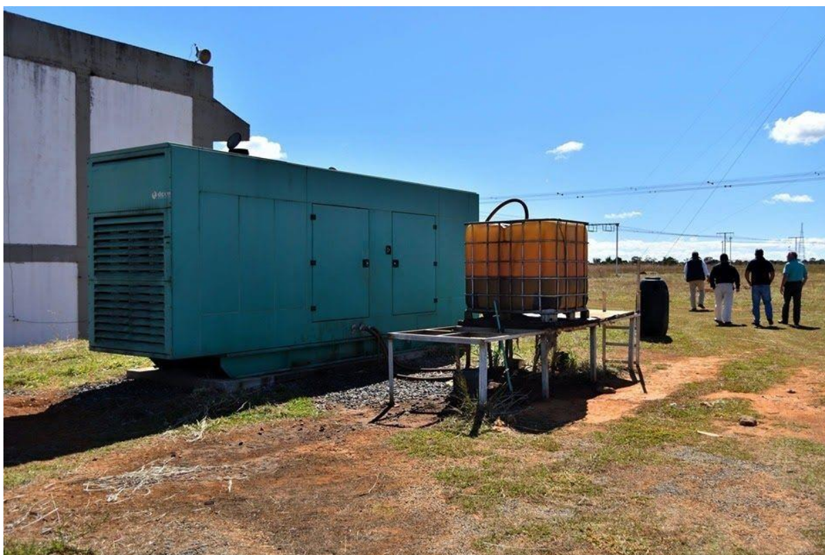
Generatore elettrico in grado di alimentare l'intera struttura.
