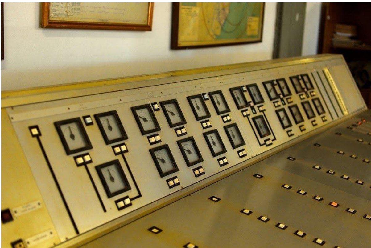
La console di commutazione che consente il collegamento di uno qualsiasi dei due trasmettitori con una qualsiasi delle antenne con la pressione di un pulsante.
