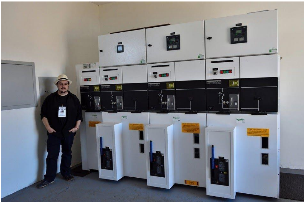
Martin Butera accanto all'attrezzatura della nuovissima sottostazione elettrica.
