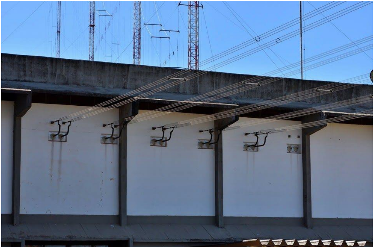
Linee di trasmissione per le antenne a onde corte che partono dall'edificio del trasmettitore.
