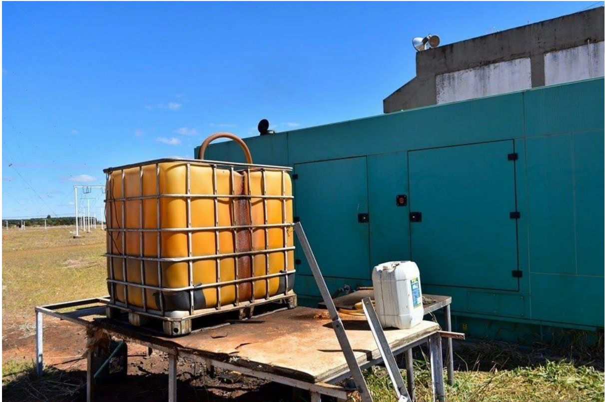
Un'altra vista del generatore elettrico
