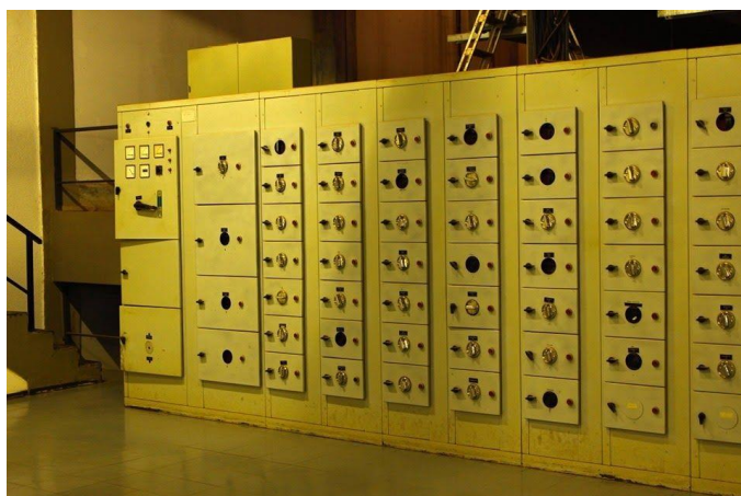
Pannello di alimentazione
