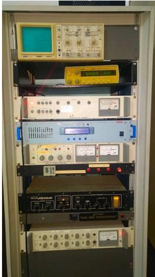
Rack di collegamento e processori audio
